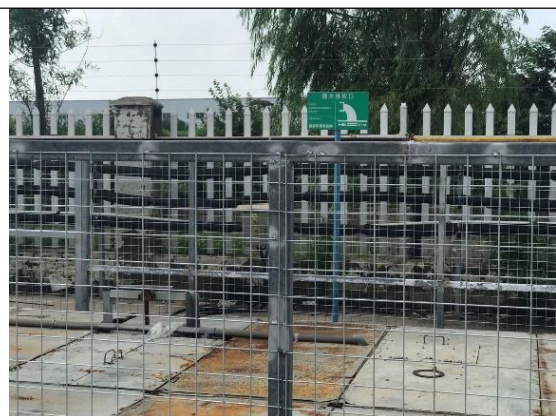
初期雨水池及雨水排放口
